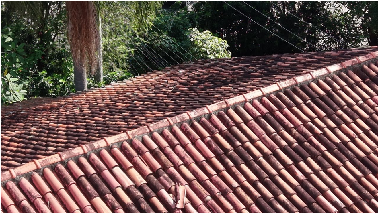
Foto 4 — Eflorescência generalizada no embasamento do Bloco C. Indica infiltração d'água pelo solo ou falha no rodapé impermeabilizante. Grau: Médio.
