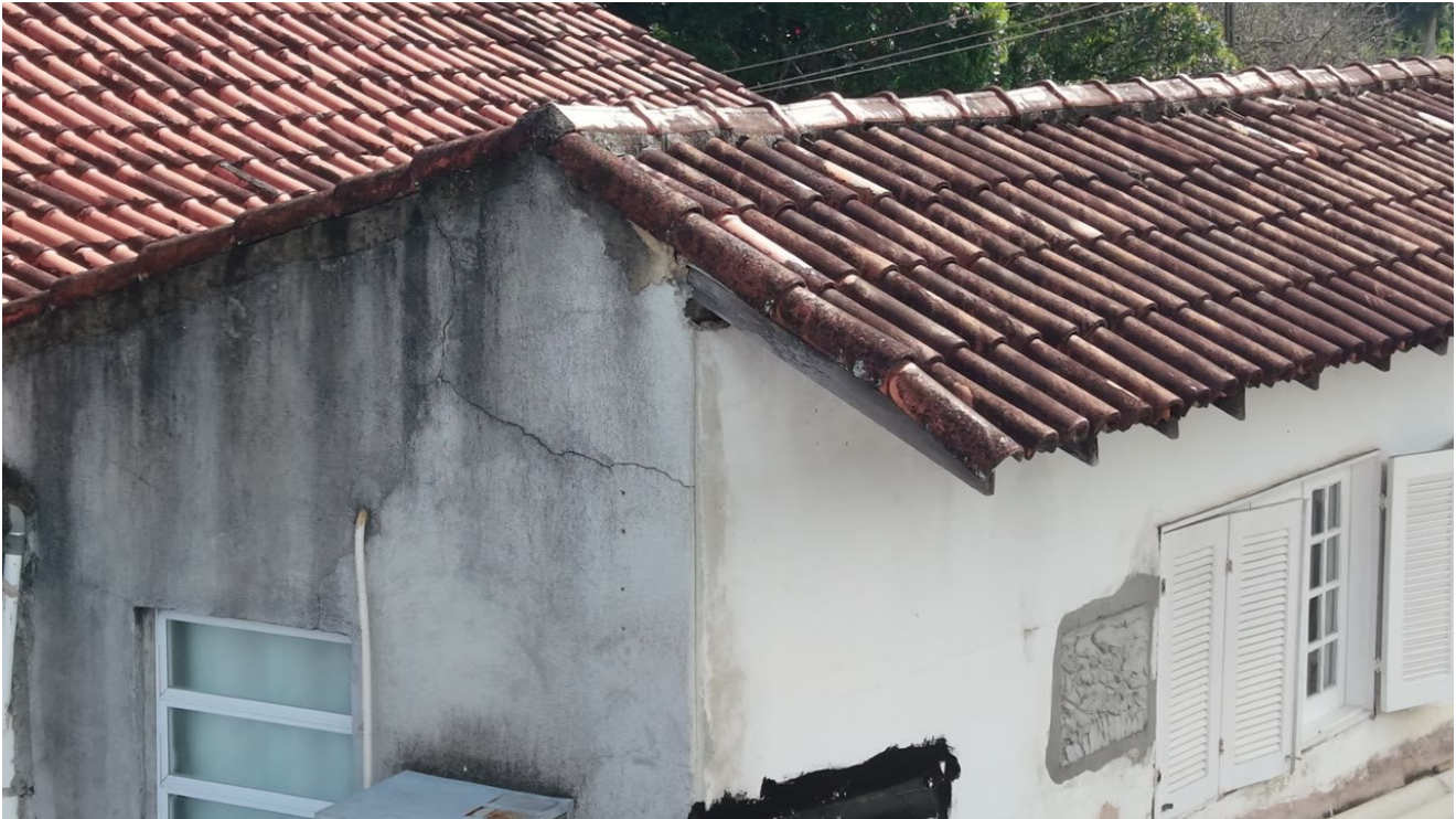
Foto 3 — Infiltração ativa na platibanda do Bloco B. Mancha de umidade progressiva visível do drone. Provável falha na impermeabilização da cobertura. Grau: Alto.
