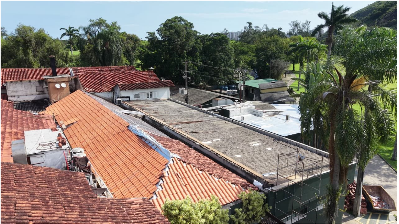
Foto 1 — Vista geral da fachada principal, Bloco A. Desplacamento de revestimento cerâmico no 12º pavimento com área estimada de 0,8m². Risco de queda. Grau: Alto.
