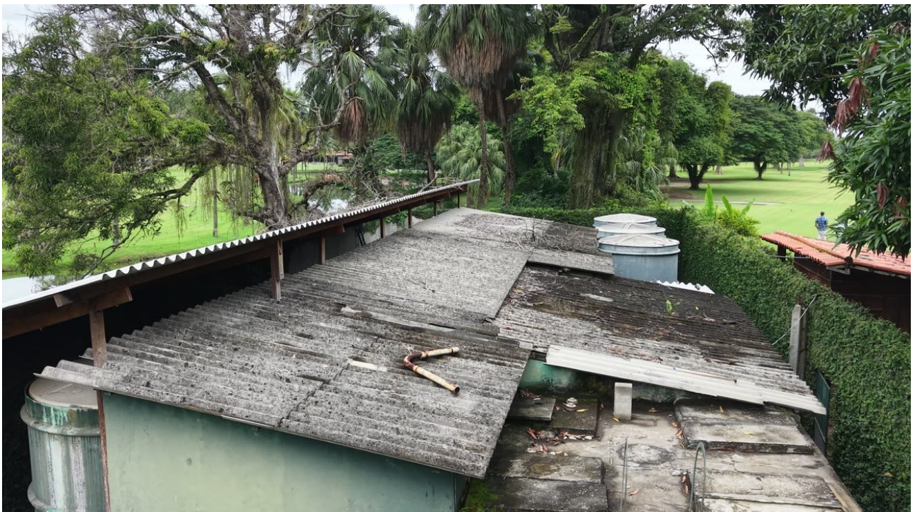
Foto 5 — Calha de drenagem do Bloco A com biofilme e acúmulo de detritos orgânicos. Risco de obstrução e sobrecarga na laje. Grau: Médio.
