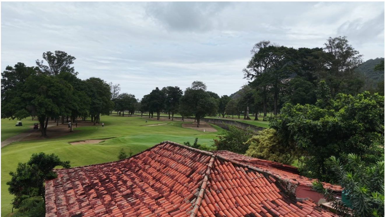
Foto 7 — Pintura degradada com exposição do substrato na fachada lateral do Bloco A. Área aproximada de 4m². Grau: Médio.
