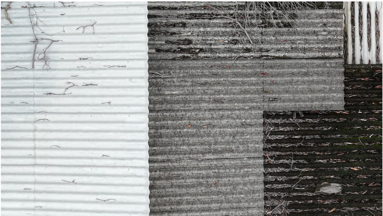
Foto 10 — Detritos e vegetação acumulados na platibanda do Bloco C. Sem dano estrutural. Grau: Baixo.
